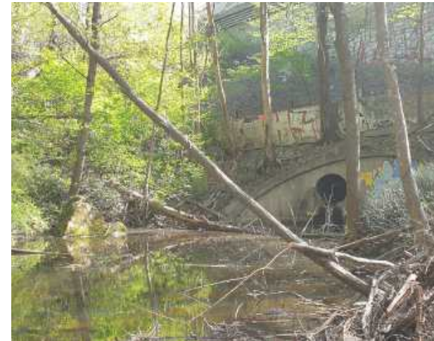
Figur 45. Kulvert under E4/E20 där bäcken mynnar ut för att sedan rinna ner mot Mälaren. Det är även här stigen när sitt slut.
