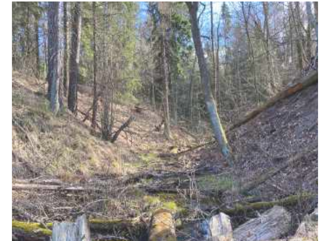
Figur 53. Strax innan bäcken leds in i vägtrumman är det svårt att urskilja bäckfåran på grund av all den ved som samlats där.
