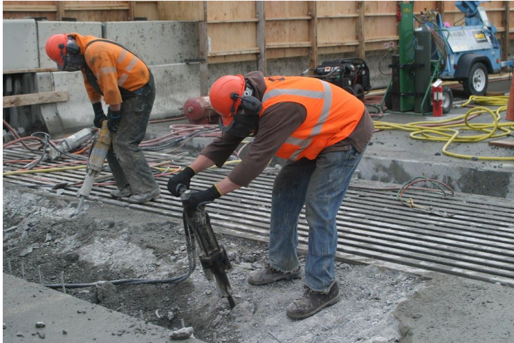
Figur 9. Vid mindre ingrepp används som illustrerat på bilden en rivningsborr. (I-90 Repair - May 5 av WSDOT CC BY-NC-ND 2.0).
