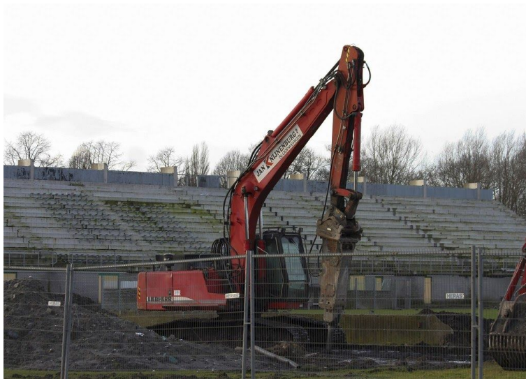
Figur 10. Exempel på val av maskin vid rivning i större omfattning är en hydraulisk hammare. (Hydraulic hammer av JvL CC BY 2.0).
