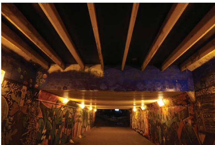
Figur 17: Taket är ojämnt och absorberar ljuset på vissa ställen
