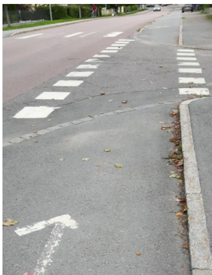
Bild 3 – Komfort. Cykelvägar med onödiga ojämnheter är mindre bekväma att cykla på. Ett exempel är kantstenar som går över cykelvägen på många ställen i Uppsala. Att undvika ojämnheter mellan material står inte med i VGU.
