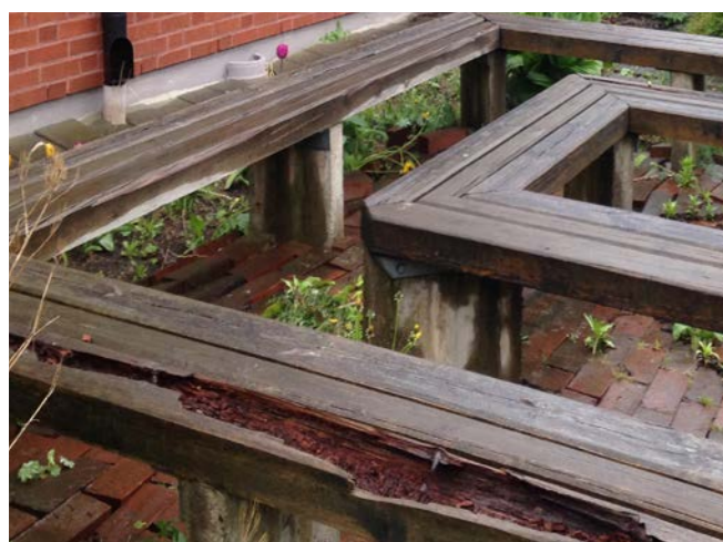
Figur 48. Bänkarna på alla gårdarna var i dåligt skick med fuktskador och flera av dem hade trasiga plankor.
