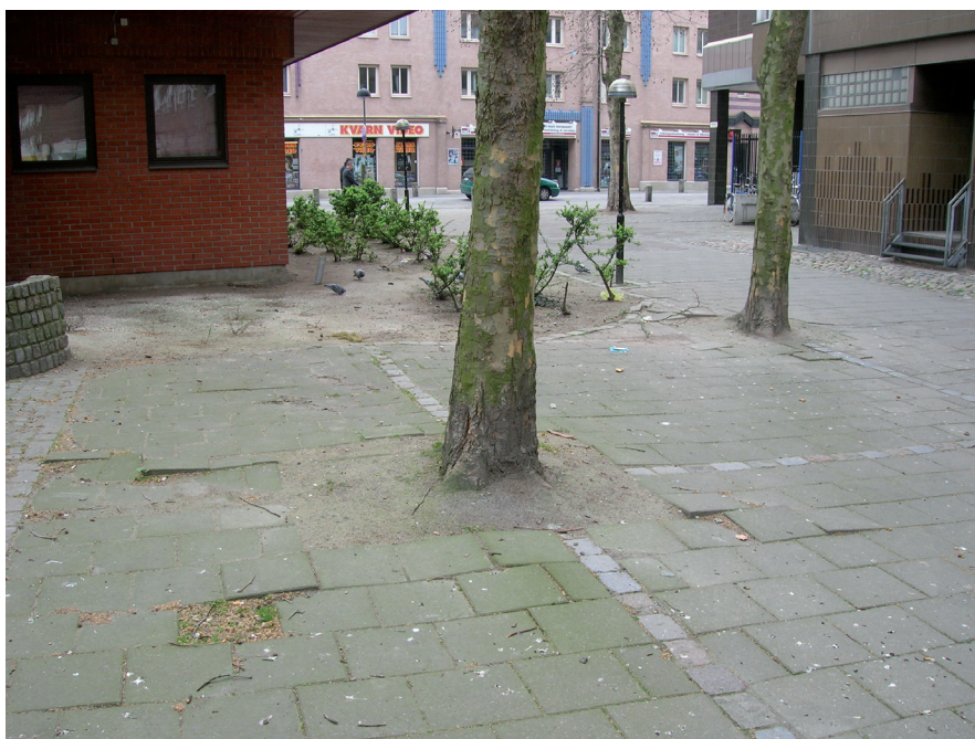
Rötter har skadat en beläggning med betongplattor i Malmö. Foto taget av Magnus Lövdahl. 27 April 2008.
