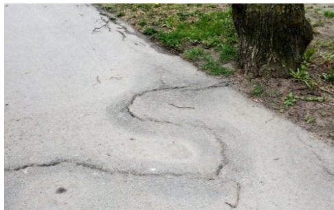
Figur 16 Asfalterad väg där en rot från ett träd sprängt sig in och bildat gupp, något som en av respondenterna svarar att hen uppskattar. Foto: My Nordström, 2017
