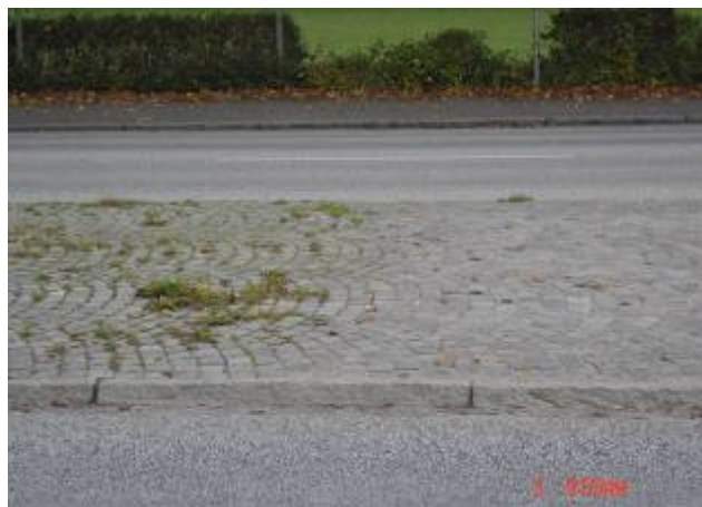
Figur 6. Här syns tydligt skillnaden på de olika fogmaterialen. AMA-fogsand till vänster och DC Coating till höger i bild.
