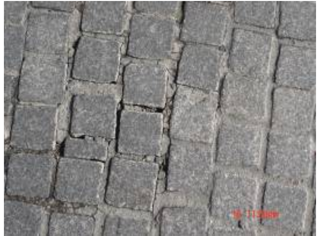
Figur 32. Betongfog med tydliga sprickor och krackeleringar.
