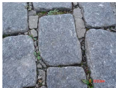
Figur 8. Sprickor i fogmaterialet.
