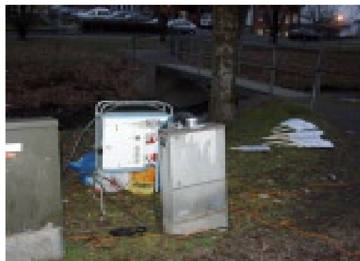
Det var mycket kablar, elektronik, armaturer m.m som skulle hållas ordning på under de här dagarna. Kungälvs Energi hjälpte mig att få ut elektricitet som bilden visar.
