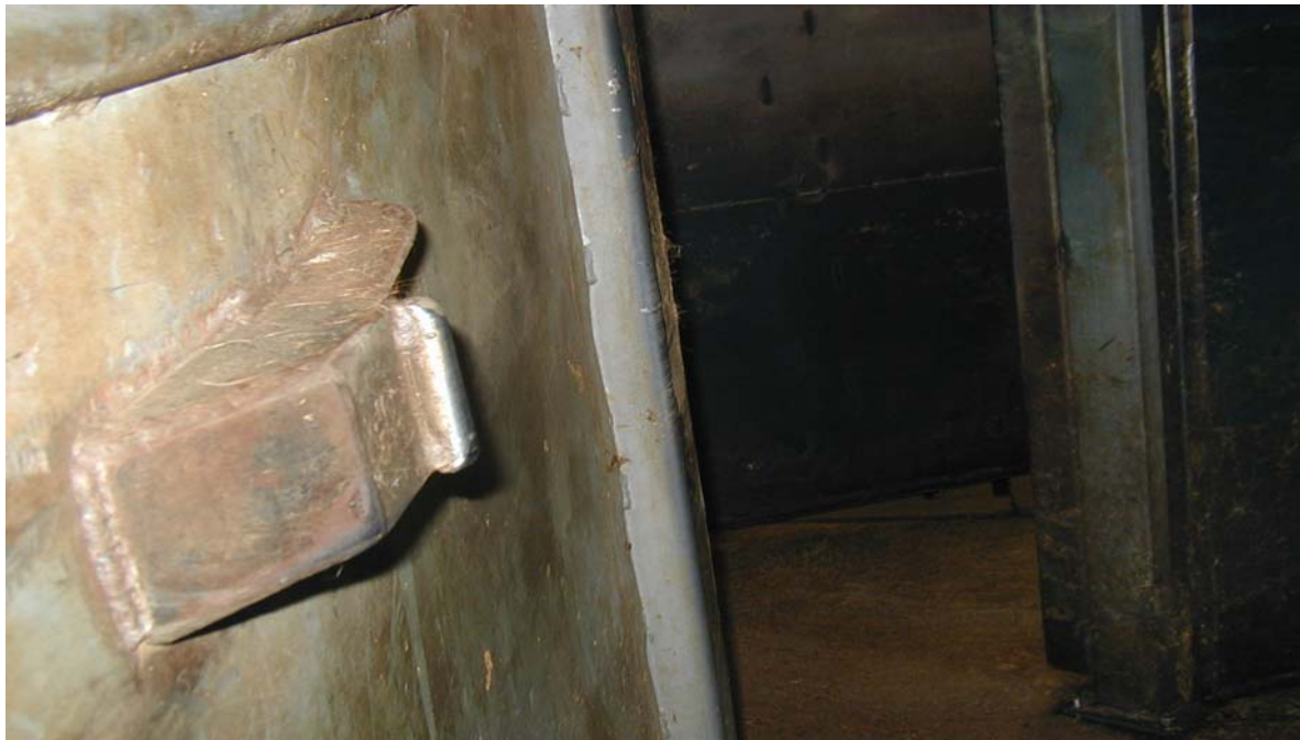
Figur 24. Bild på balken (sett bakifrån) som sticker ut på höger sida på vägen in i skjutboxen i Uppsala.
