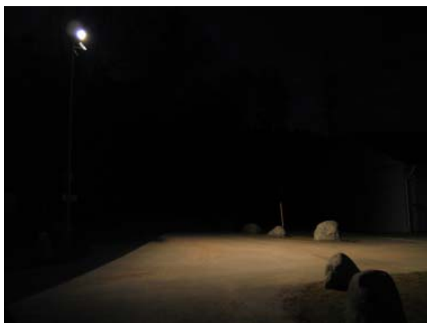
En strålkastare vid parkeringen styrs av en rörelsedetektor.
