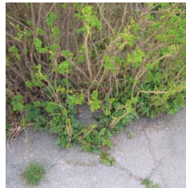
Bild 113. Vresros som bryter genom asfalt, Galonvägen 41
