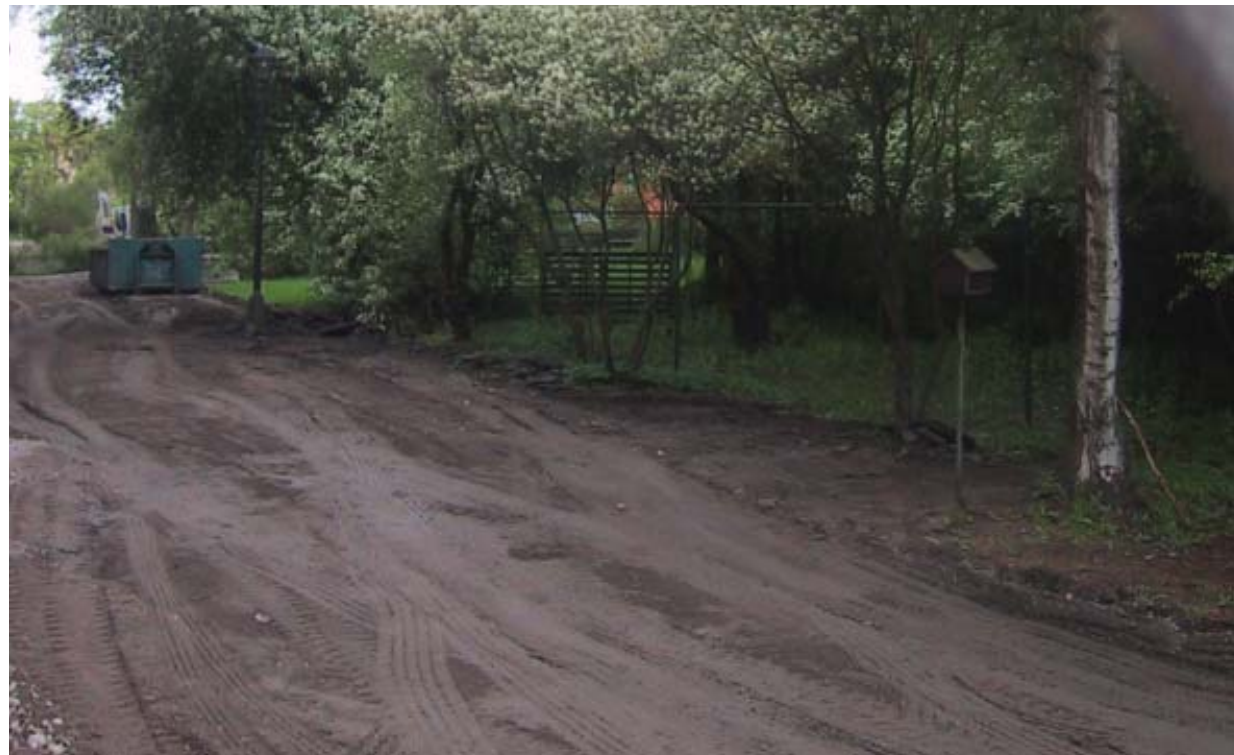
Bild 34. Entréytan vid Galonen, Stramaljevägen 2-10, efter det att dräneringsarbete utförts. Delar av den ursprungliga vegetationen runt tork- och piskplatserna är borttagen. Gräsytan har också "naggats i kanten".
