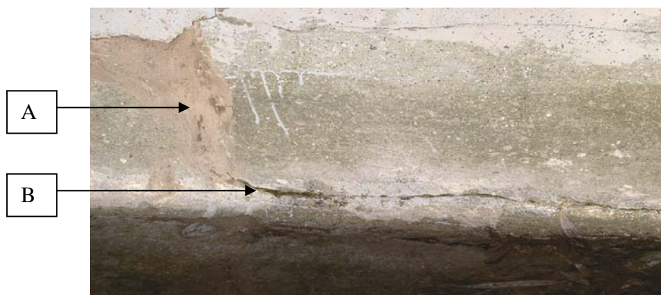
Bild 2: Sprickor och lagning
