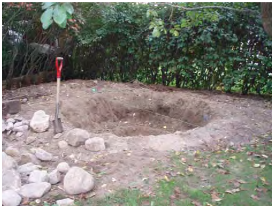
Dammybygget 2006-09-27. Hålet är ca 80 cm djupt i mitten.
